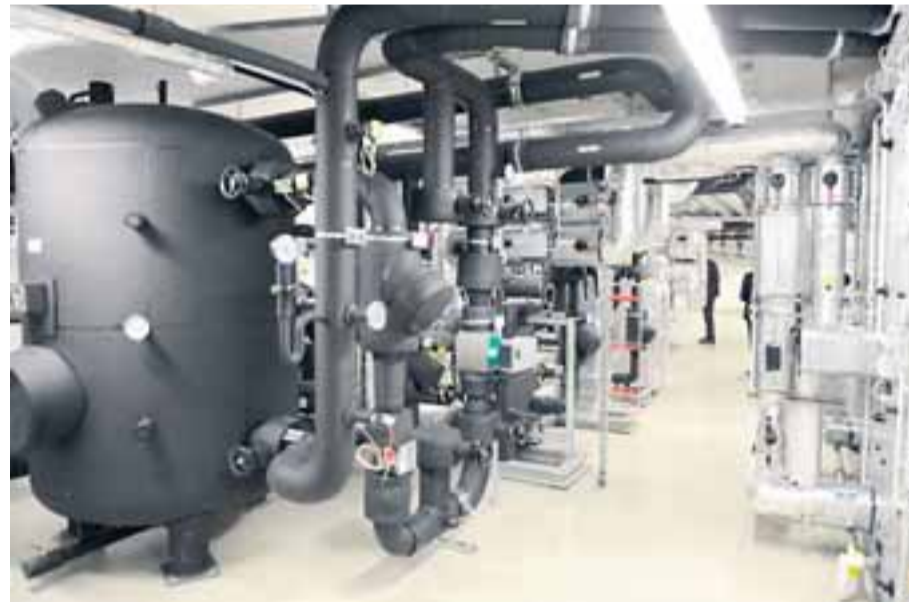
High-Tech: Moderne Heiztechnik, darunter eine Absorptionswärmepumpe, die mit Fernwärme betrieben wird, soll den Energieverbrauch auf ein Minimum begrenzen.
